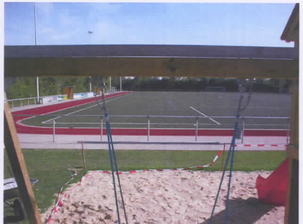
Bild 2: Verformung des Balkens
