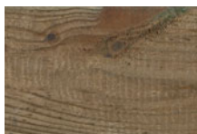
Raue Stellen auf der Holzoberfläche
