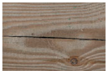
Spannungsrisse durch die Holztrocknung
