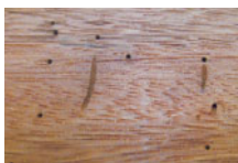
„Pinholes“ bei überseeischen Harthölzern
