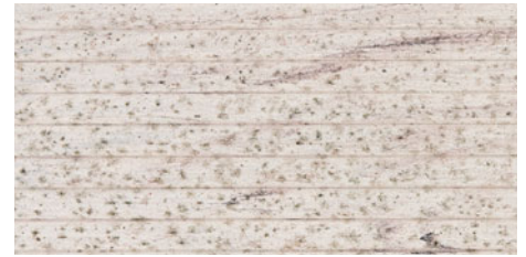
Stockflecken/Schimmel auf der Oberfläche
