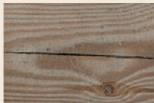
Fissures de contrainte provoquées par le séchage du bois
