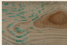
Efflorescences de sels d'imprégnation verdâtres
