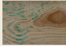
Efflorescences de sels d'imprégnation verdâtres
