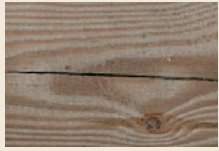
Fissures de contrainte provoquées par le séchage du bois
