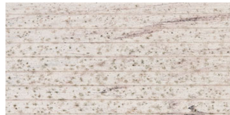
Stockflecken/Schimmel auf der Oberfläche
