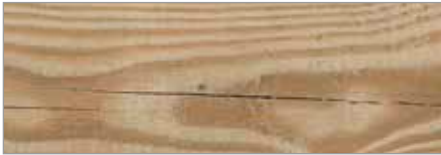
Trocknungsrisse (nach DIN zulässig)
