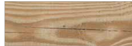
Trocknungsrisse (nach DIN zulässig)
