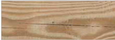
Trocknungsrisse (nach DIN zulässig)
