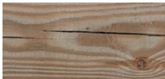
Spannungsrisse durch die Holz Trocknung
