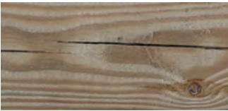
Spanningsscheurtjes door de houtdroging
