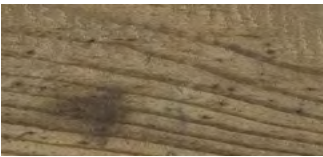
Schimmelvlekken en lichte schimmel
